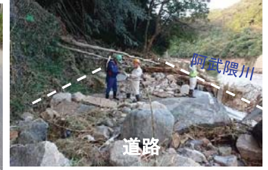
国道349号 土砂崩落・路肩流出
