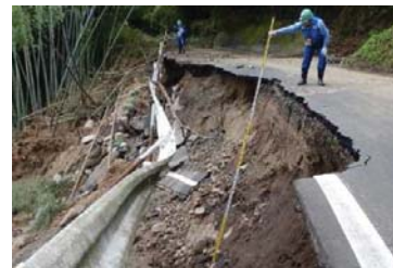
国道349号 路肩流出
